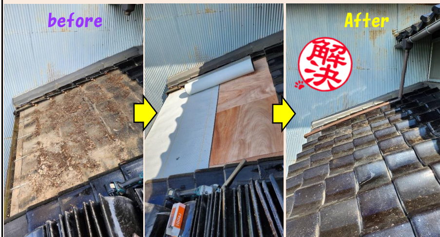
雨漏りしていた自宅屋根の葺き直し工事を行いました。
