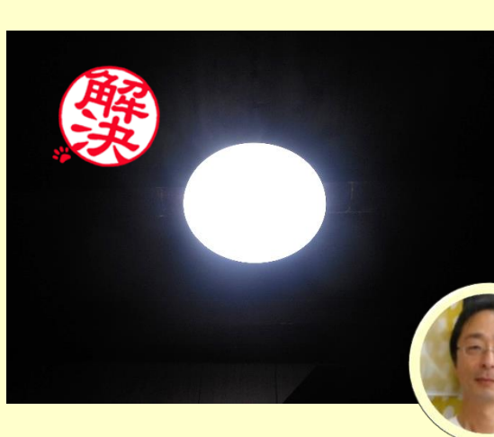
LED蛍光灯の器具を交換しました。
