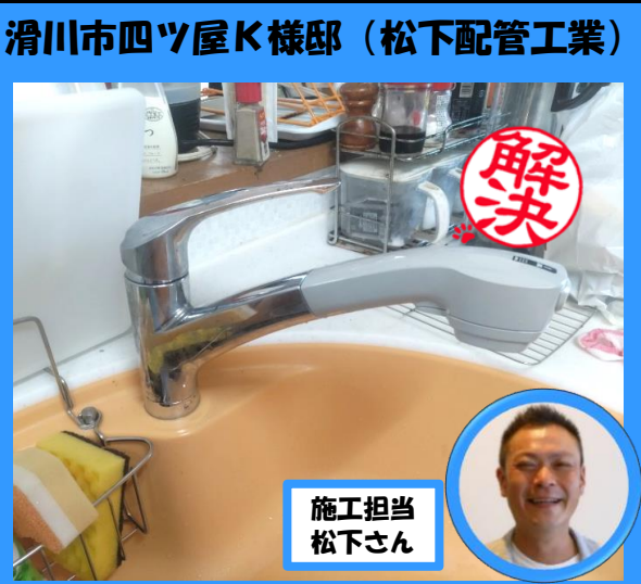
滑川市四ツ屋K様邸 (松下配管工業) 洗面所の蛇口等を交換しました。
