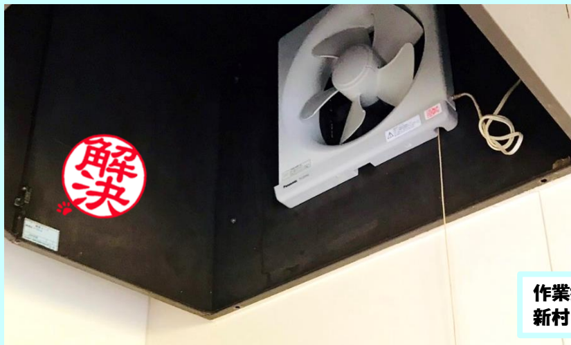
台所の換気扇レンジフードのクリーニングを行いました。
